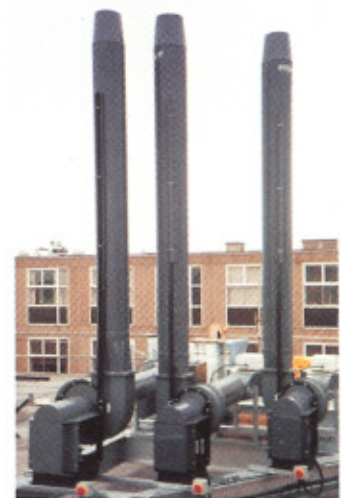
Fan units & discharge stacks
